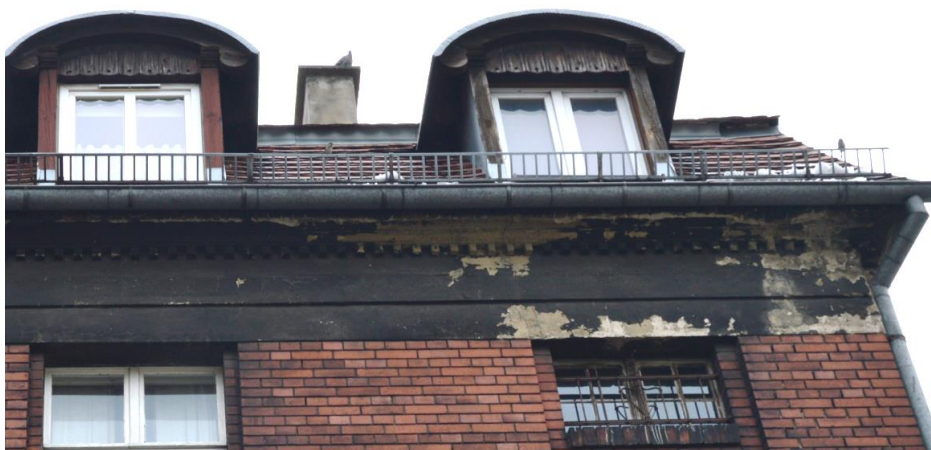
Rys. 31. Ubytki tynków i zabrudzenia gzymsu dachowego; złuszczenia powłoki malarskiej na drewnianym wykończeniu lukarn [1.4].
