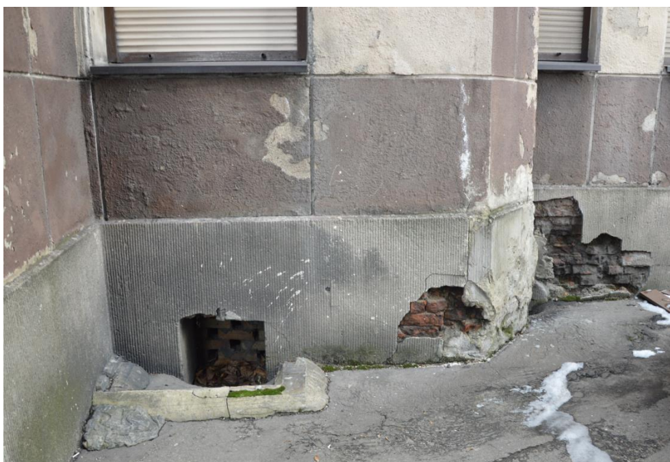
Rys. 29. Odspojenia, spękania i ubytki tynków oraz cegieł w strefie cokołowej [1.4].
