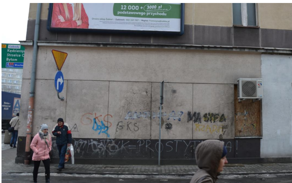
Rys. 27. Dewastacja - napisy graffiti; korozja obróbki gzymsu [1.4].
