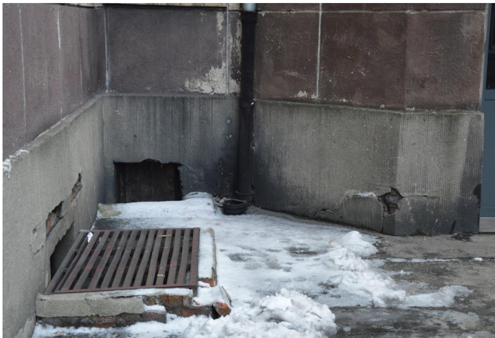
Rys. 28. Odspojenia, spękania i ubytki tynków w strefie cokołowej; zdegradowane naświetla piwniczne [1.4].
