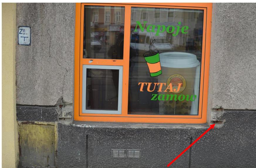
Rys. 25. Zarysowania i ubytki tynków; bruzdy po zdemontowanych parapetach [1.4].
