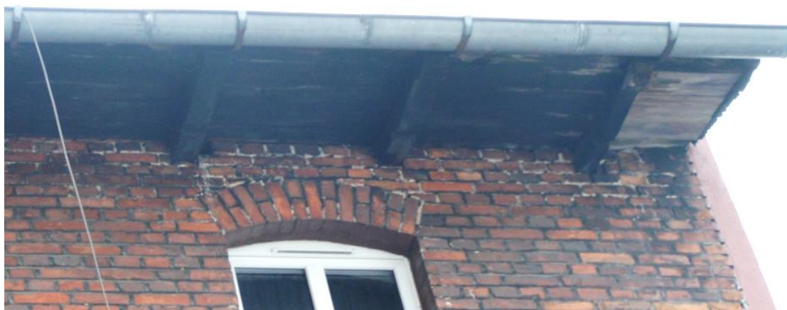
Rys. 40. Zawilgocone deskowanie dachu w strefie okapowej; korozja rynhaków [1.4].
