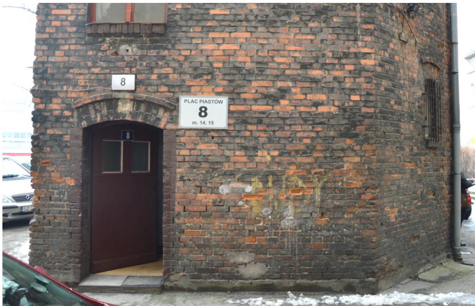
Rys. 41. Wypłukane spoiny przy wejściu do klatki schodowej [1.4].
