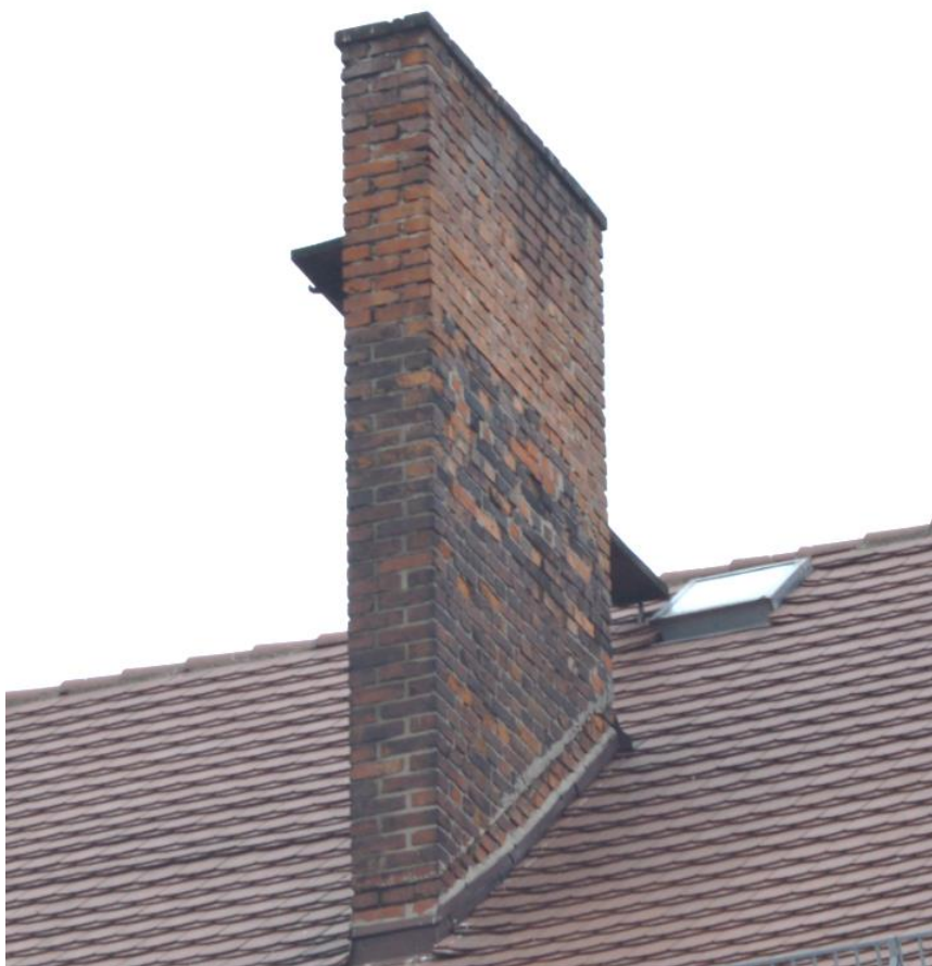
Rys. 24. Wyplukanie spoin i ubytki cegieł na jednym z kominów [1.4].
