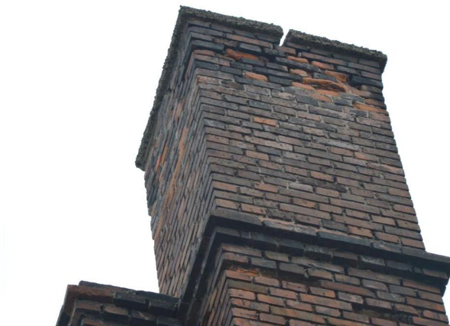
Rys. 39. Wyplukanie spoin oraz ubytki cegieł w górnej partii komina [1.4].
