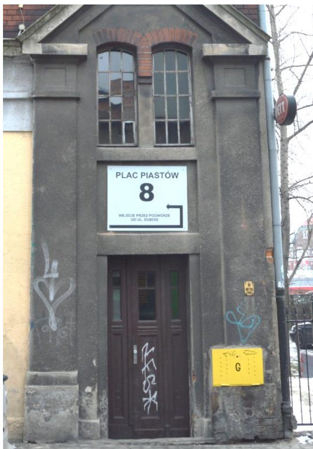
Rys. 33. Zdewastowane drzwi wejściowe [1.4].
