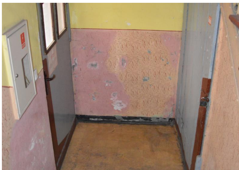
Rys. 45. Zabrudzenia i zawilgocenia ściany przy wejściu [1.4].
