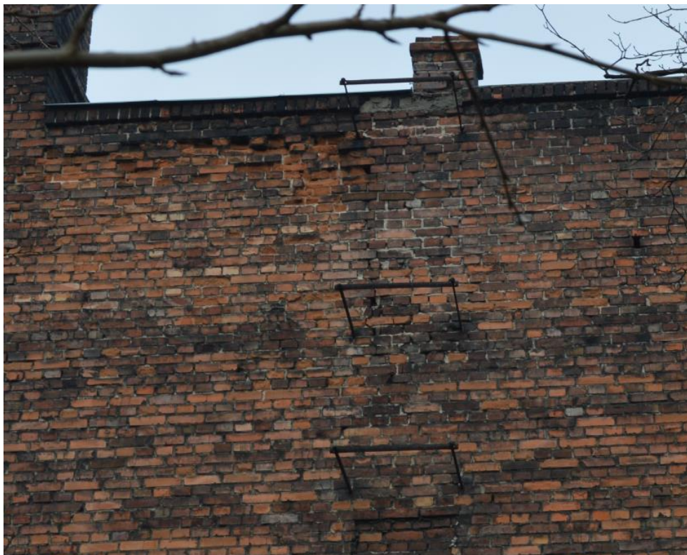
Rys. 37. Spękanie muru oraz ubytki cegieł na elewacji południowo – wschodniej; zbędne wsporniki metalowe [1.4].
