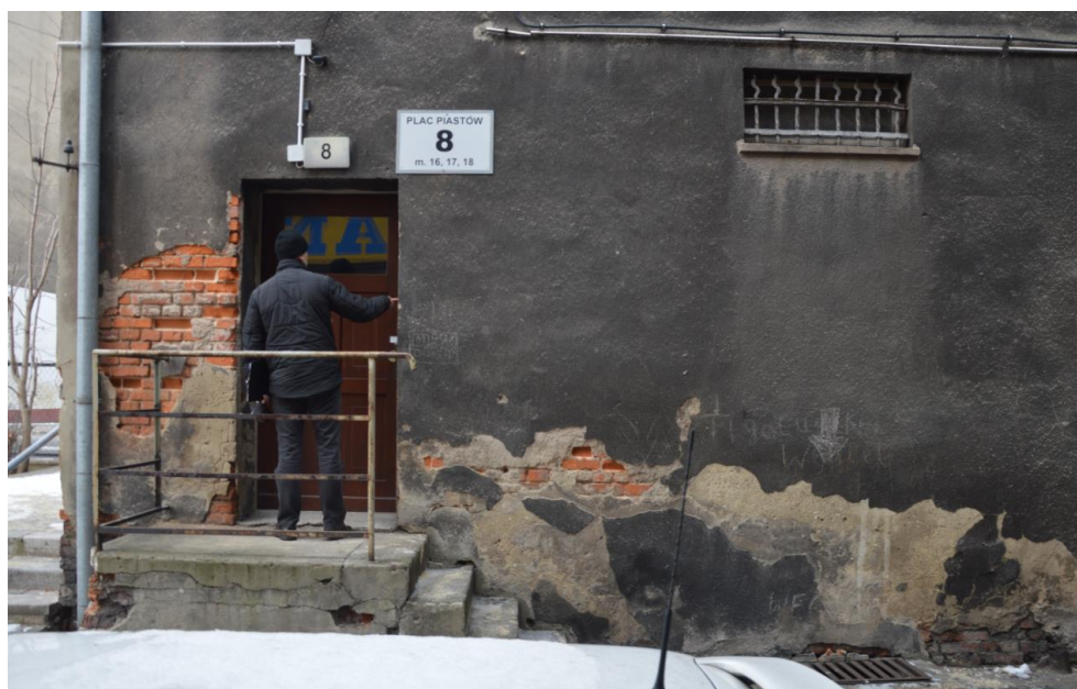
Rys. 34. Ubytki tynków i cegieł przy wejściu do oficyny 1 [1.4].
