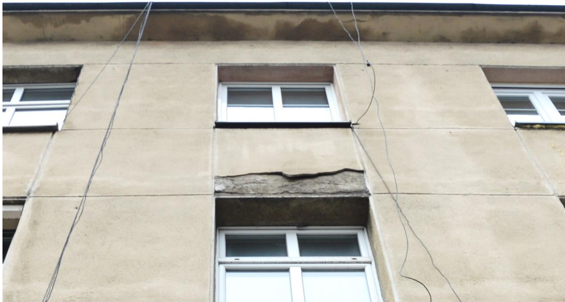
Rys. 23. Odspojenia i ubytki tynku, zacieki na gzymsie dachowym [1.4].
