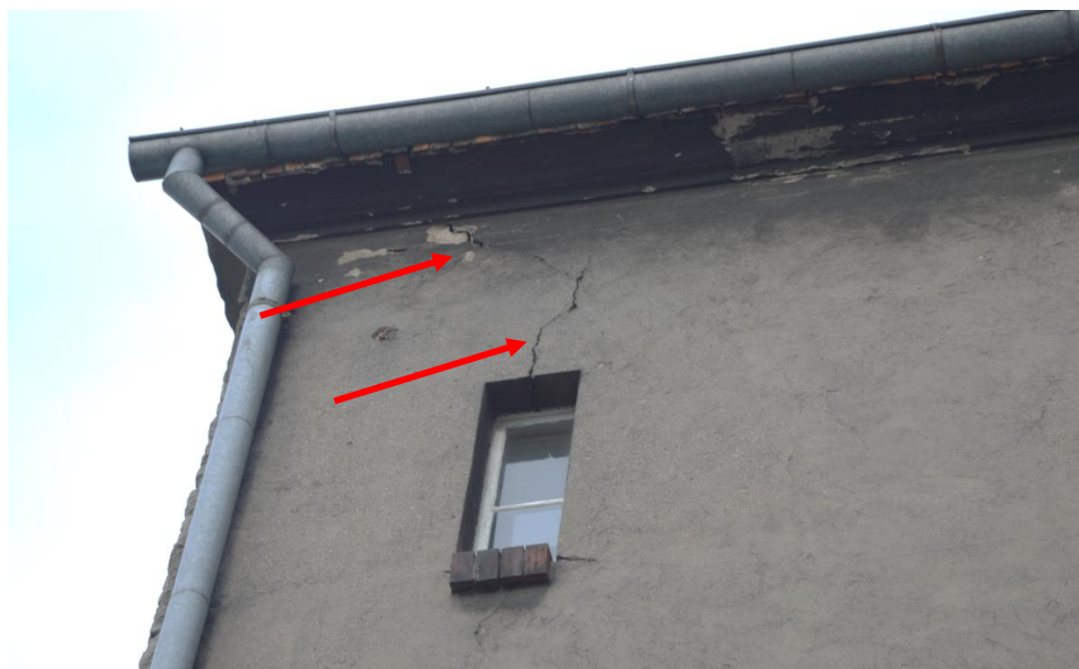
Rys. 35. Spękanie muru nad oknem, odspojenia tynku na gzymsie dachowym [1.4].
