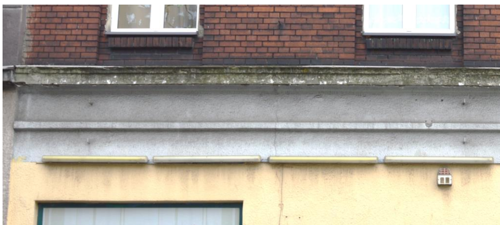
Rys. 32. Korozja biologiczna na gzymsie [1.4].
