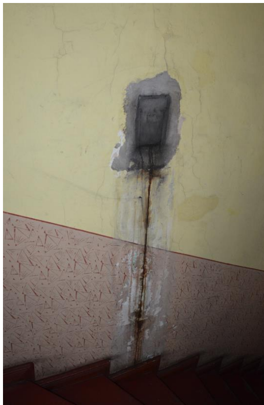
Rys. 44. Zacieki z otworu rewizyjnego komina na klatce schodowej [1.4].
