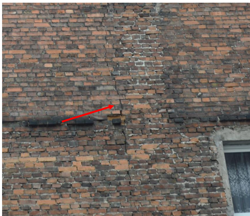
Rys. 36. Spękanie muru na elewacji południowo - wschodniej [1.4].
