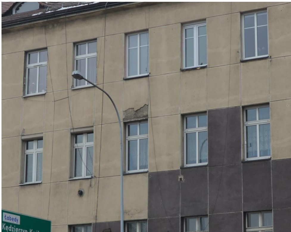
Rys. 26. Nieuporządkowane, luźne okablowanie na elewacji [1.4].
