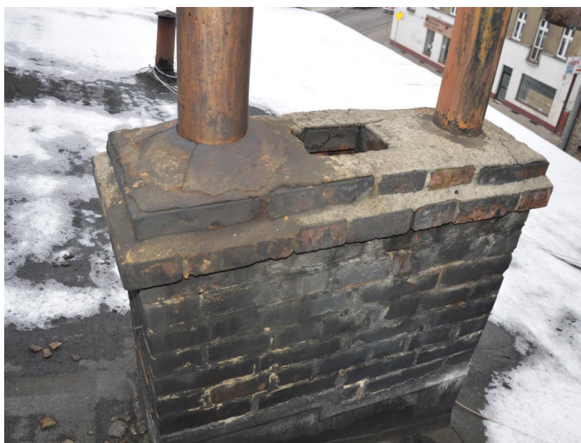
Rys. 42. Zabrudzenia komina; korozja nasad kominowych [1.4].
