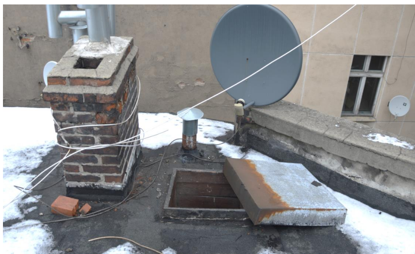
Rys. 43. Korozja klapy wylazu dachowego; ubytki cegieł komina [1.4].
