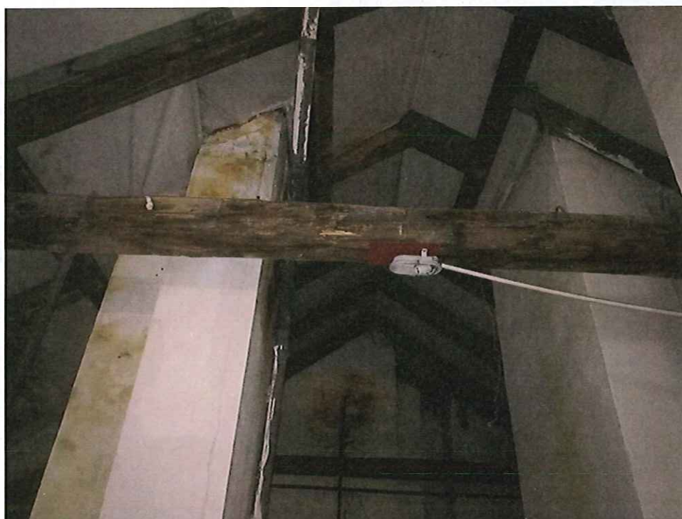
Fot. 8 Zagrzybione tynki kominowe, zaatakowany przez owady kleszcz Ks5
