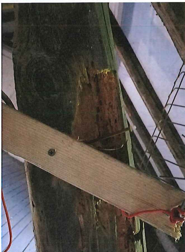
Fot. 20 Żerowisko owadów niszczących drewno – zastrzał Z5
