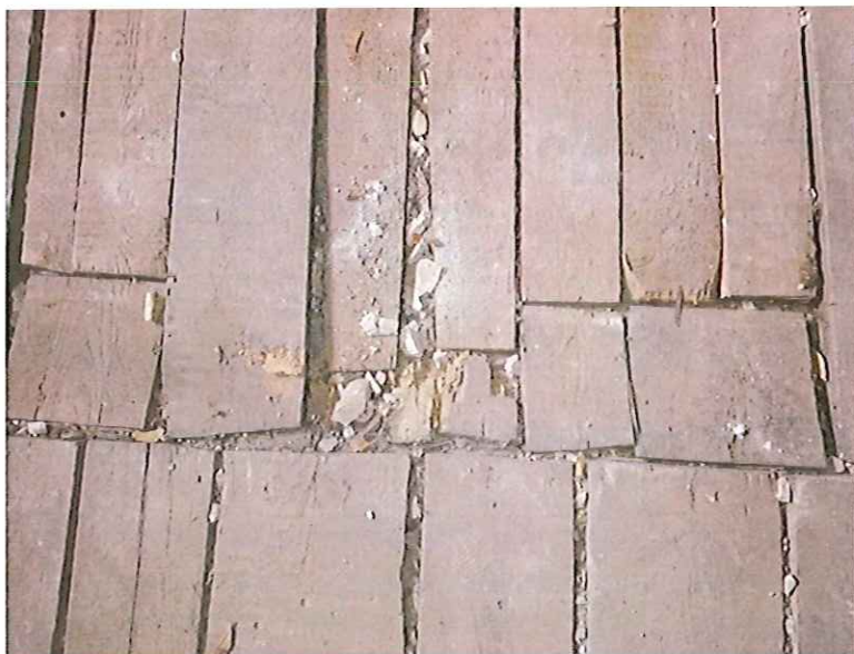
Fot. 18 Zapadnięte deski posadzkowe
