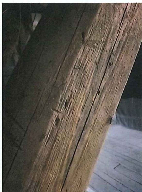
Fot. 14 Zastrzał Z9 - owalne otwory wylotowe Spuszczela pospolitego
