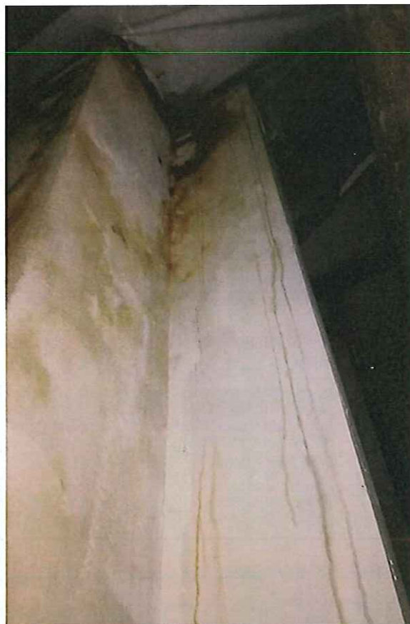
Fot. 32 Naroże - widoczne ciemnobrunatne plamy i zacieki
