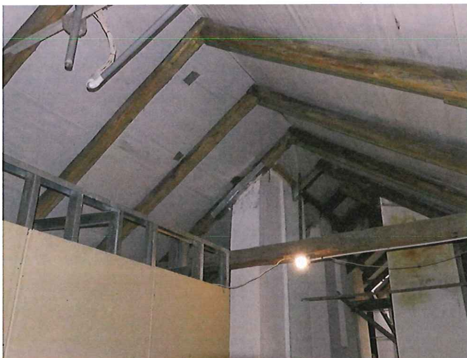
Fot. 7 Widok krokwi - stan ogólny średni
