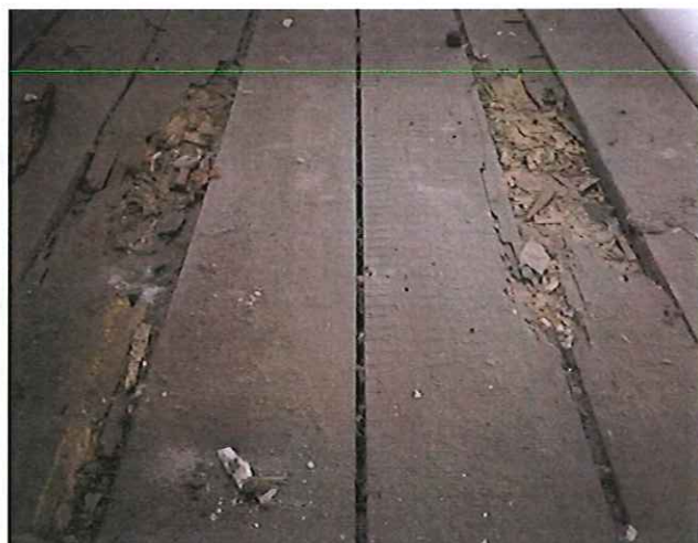
Fot. 4 Żerowiska owadów z kawałkami rozpadającej się posadzki
