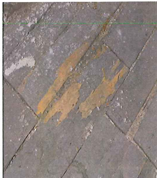
Fot. 19 Zniszczona posadzka cd.
