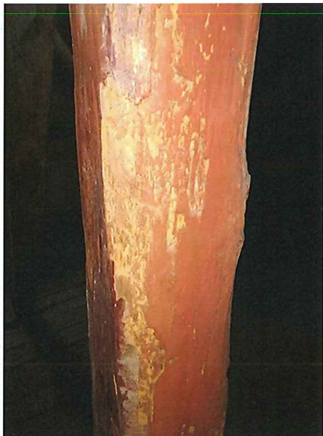
Fot. 25 Słup S5 - Charakterystyczne drążenie po penetracji słupa przez owady
