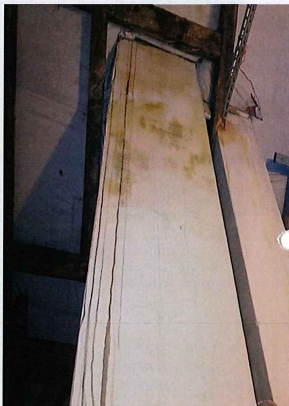
Fot.29 Zacieki na obudowie szachtu instalacyjnego
