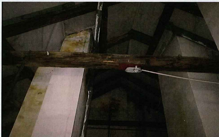
Fot. 30 Prawie każda z ścian obudowy zagrzybiona i zawilgocona...
