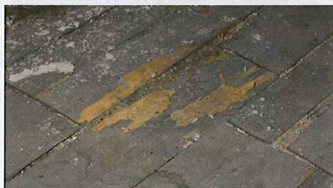
Fot. 12 Stosunkowo nie duże uszkodzenie - prawdopodobnie nowe, nie dawno powstałe żerowisko szkodników
