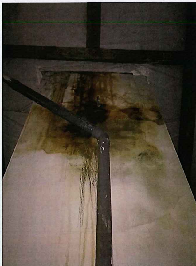
Fot. 31 Zagrzybiona i zawilgocona obudowa; widoczna rura instalacji sanitarnej
