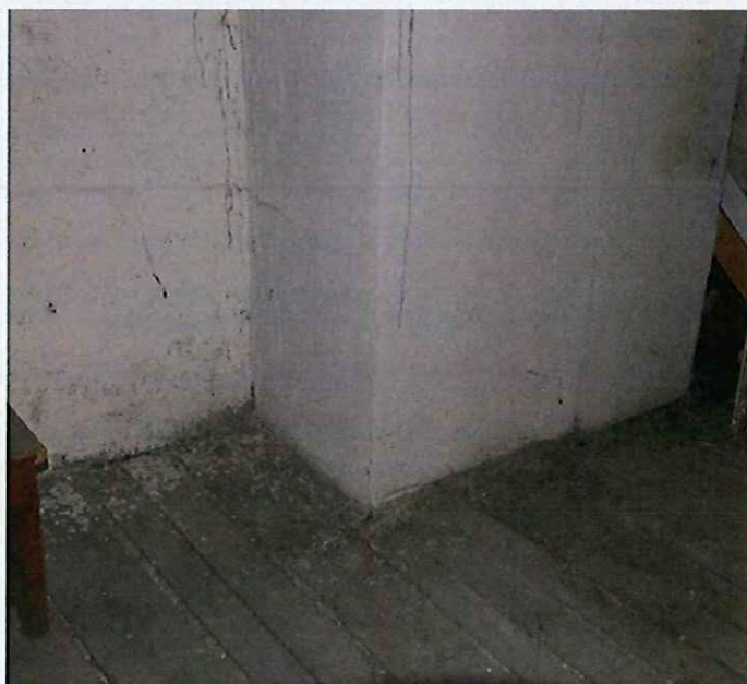
Fot. 9 Zniszczenie posadzki przy obudowie szachtu instalacyjnego
