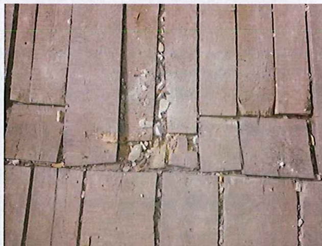
Fot. 8 Zapadnięta posadzka cd.
