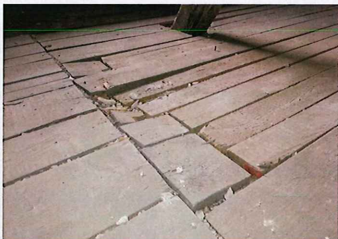
Fot. 7 Zapadnięta posadzka
