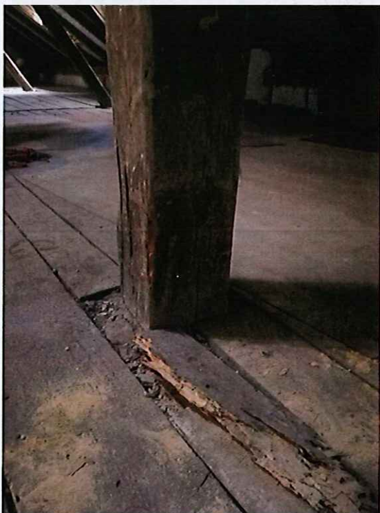
Fot. 1 Zaatakowana posadzka w pobliżu słupa więźby dachowej
