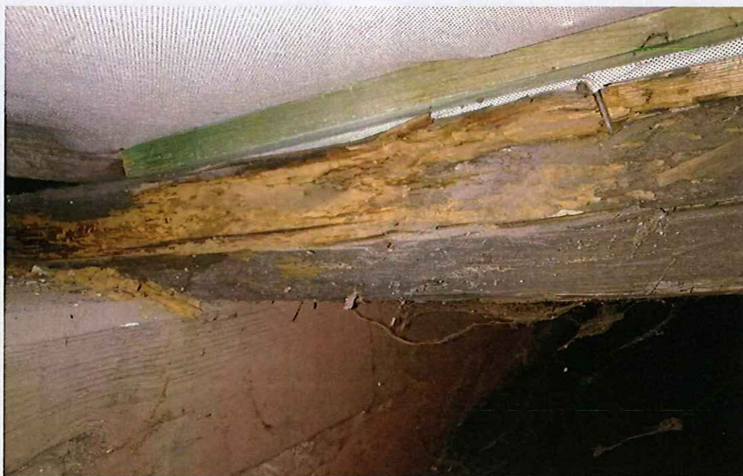
Fot. 24 Oparcie krokwi K6 na murłacie M1 – czynne żerowisko owadów spuszczela pospolitego; widoczna mączka drzewna na murłacie
