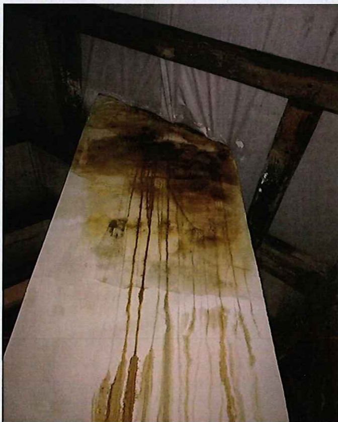
Fot. 28 Ciemno brunatne plamy i zacieki ; widoczne porażenie elementów konstrukcji więźby dachowej (tu wymian W9 i W10) pleśnią
