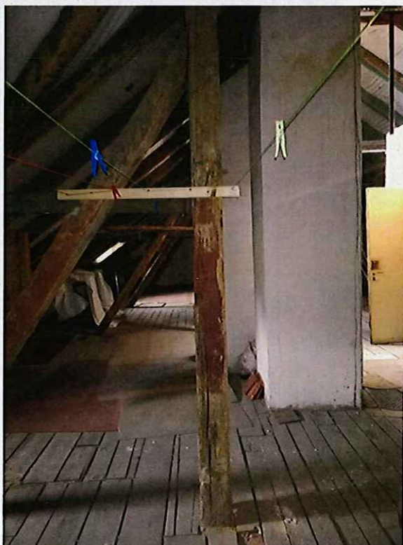
Fot. 17 Widoczne spękania podłużne na słupie S7
