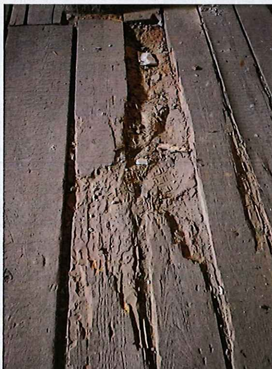
Fot. 2 Rozległe i głębokie uszkodzenie posadzki
