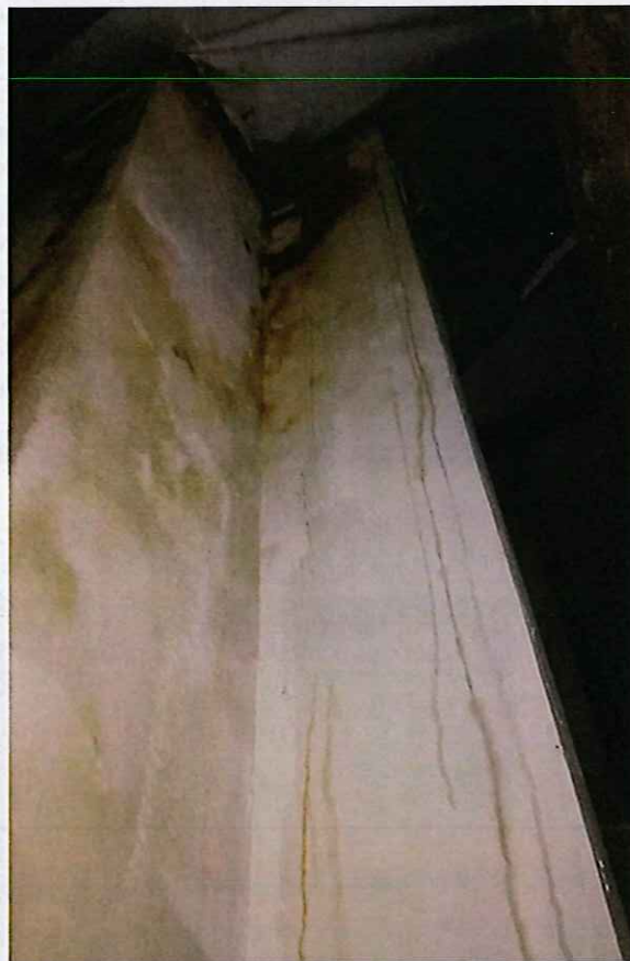
Fot. 32 Naroże - widoczne ciemnobrunatne plamy i zacieki
