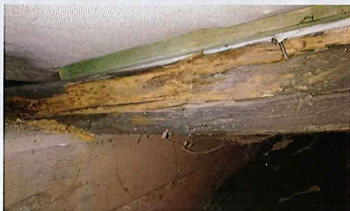
Fot. 25 Miejsce podporowe - miejsce żerowania owadów niszczących drewno
