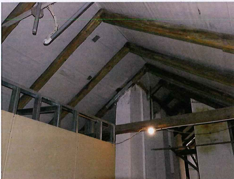
Fot. 7 Widok krokwi - stan ogólny średni
