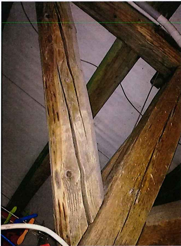
Fot. 12 Podłużne spękania słupa S5 oraz miecza M7 spowodowane skurczem starzeniowym i wilgotnościowym.
