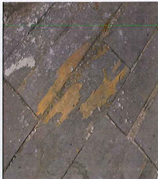
Fot. 19 Zniszczona posadzka cd.
