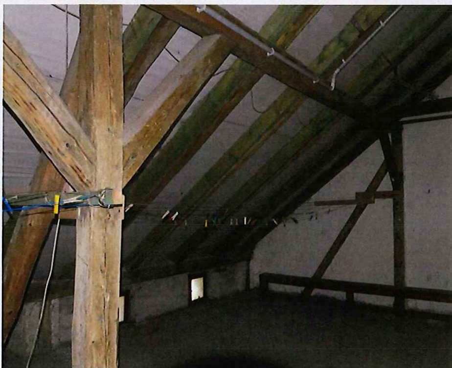
Fot. 6 Widok S12, S4, krokiew – stan techniczny średni
