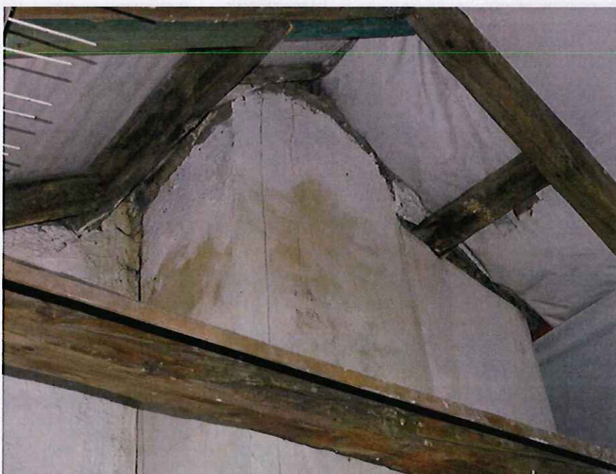
Fot. 15 Zawilgocony tynk kominowy, początek rozwoju grzybów pleśniowych
