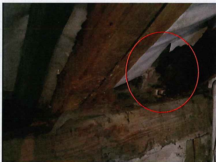
Fot. 24 Zniszczone przekroje podporowe (oparcie krokwi na murlacie)
