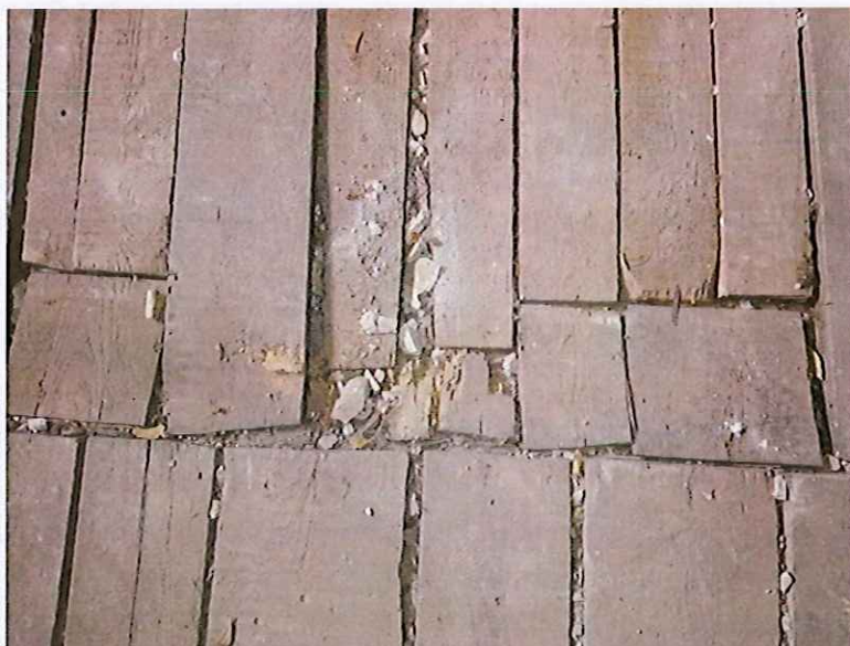
Fot. 18 Zapadnięte deski posadzkowe
