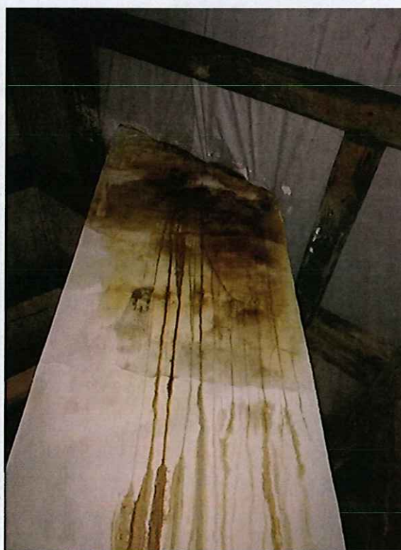
Fot. 11 Zawilgocony i zagrzybiony tynk kominowy oraz wymiany W11 i W13
