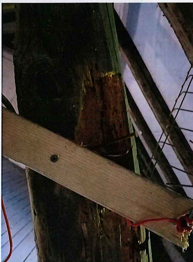
Fot. 20 Żerowisko owadów niszczących drewno – zastrzał Z5
